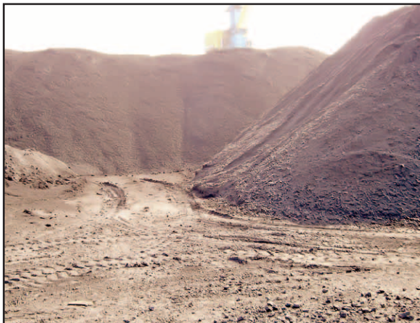
Рис. 6. Просадки незакрепленной илцементными сваями территории в тыловой зоне причала
