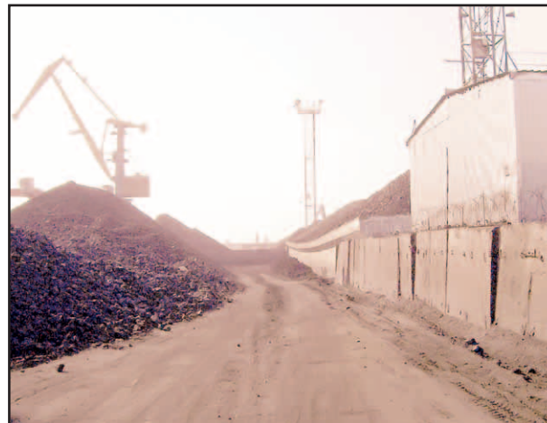
Рис. 8. Тыловая зона незакрепленной территории грузового причала с ярко выраженными просадками
